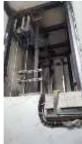
Figura 14. Ascensor visto desde el interior del cuarto de mantenimiento. (Elaboración propia)
