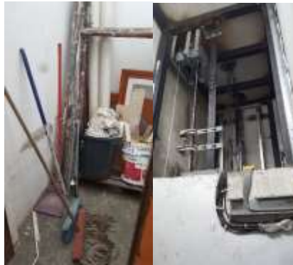
Figura 8. Cuartos de mantenimiento. (Elaboración propia)
