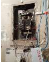
Figura 13. Equipos y elementos en el interior del cuarto de comunicaciones. (Elaboración propia)
