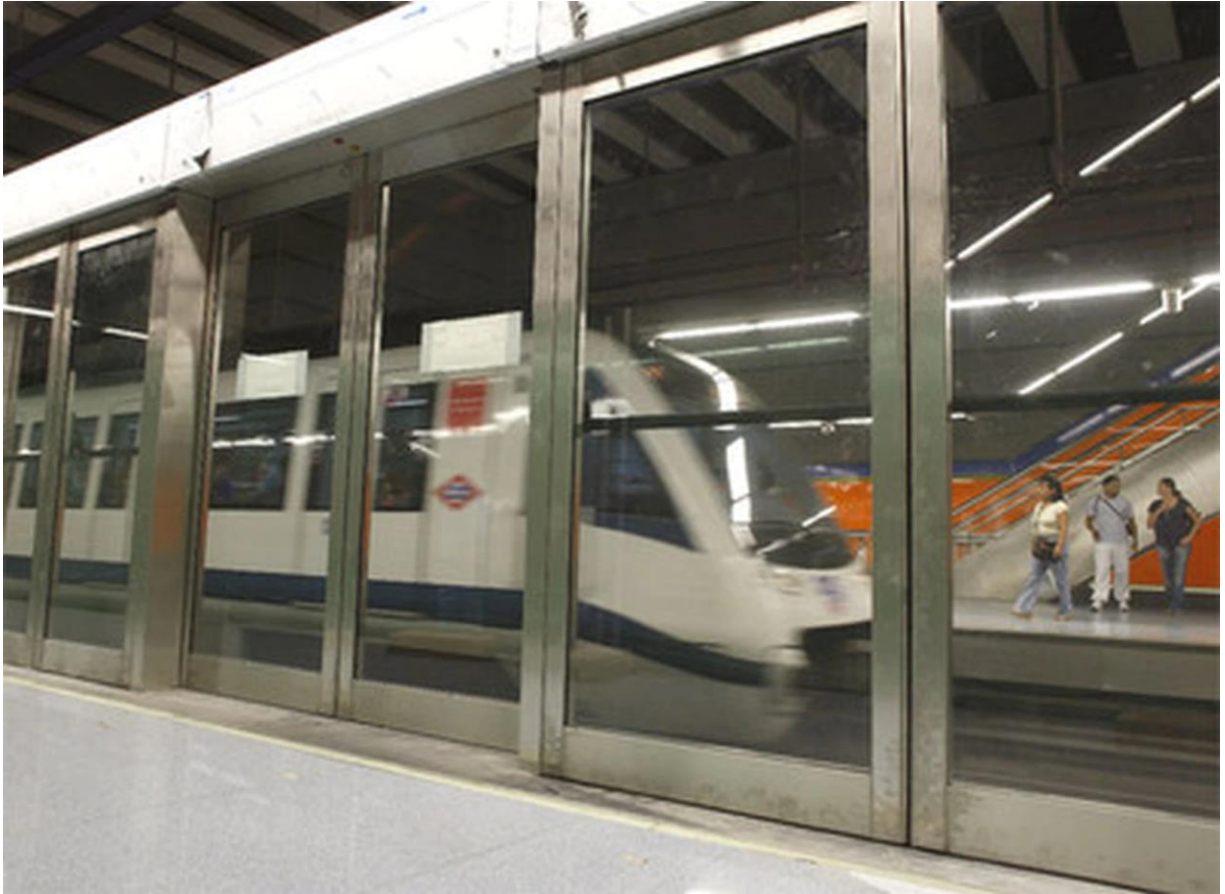
Figura 20. Mamparas de seguridad instaladas en fase de prueba en Metro Madrid.
