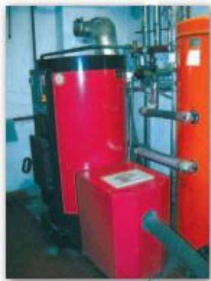
FIGURA 38. CALDERA PARA VIVIENDA UNIFAMILIAR (COMUNIDAD DE MADRID, 2006, p.18)
