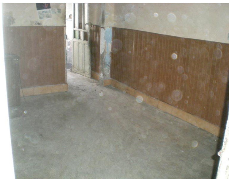
Imagen de dormitorio de vivienda tras la retirada de basuras. Fuente: Servicio de Salud Municipal. Ayuntamiento de Sevilla. 2015.
