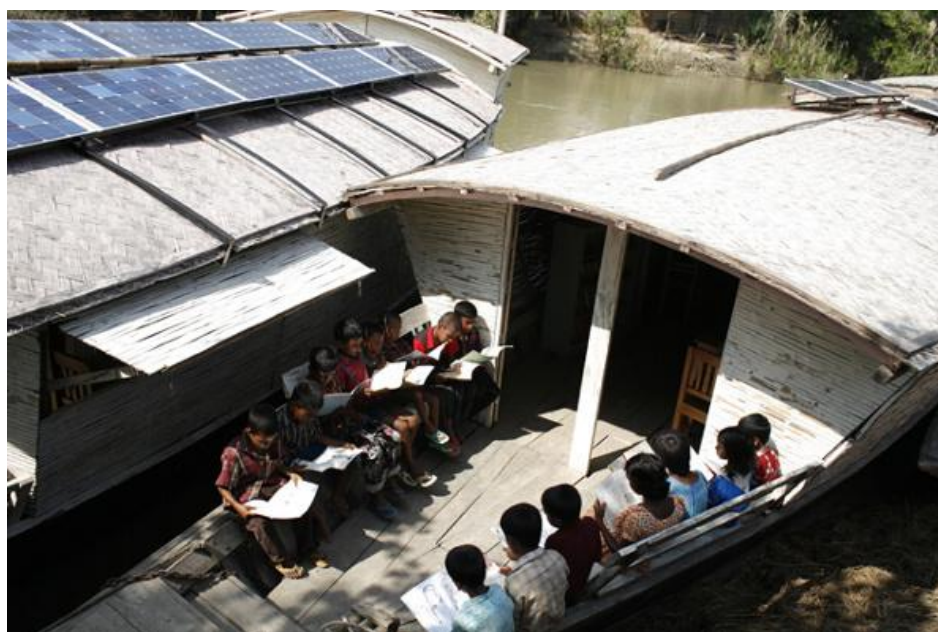
Figura 40: Paneles solares instalados en el tejado de estas escuelas barco ( http://generatuenergia.com/2012/11/19/escuelas-flotantes-solares-llevar-educacion-y-desarrollo-a-zonas-inundables-bangladesh/ ).
