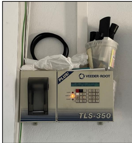
Figura 15. Medidor automático de tanques
