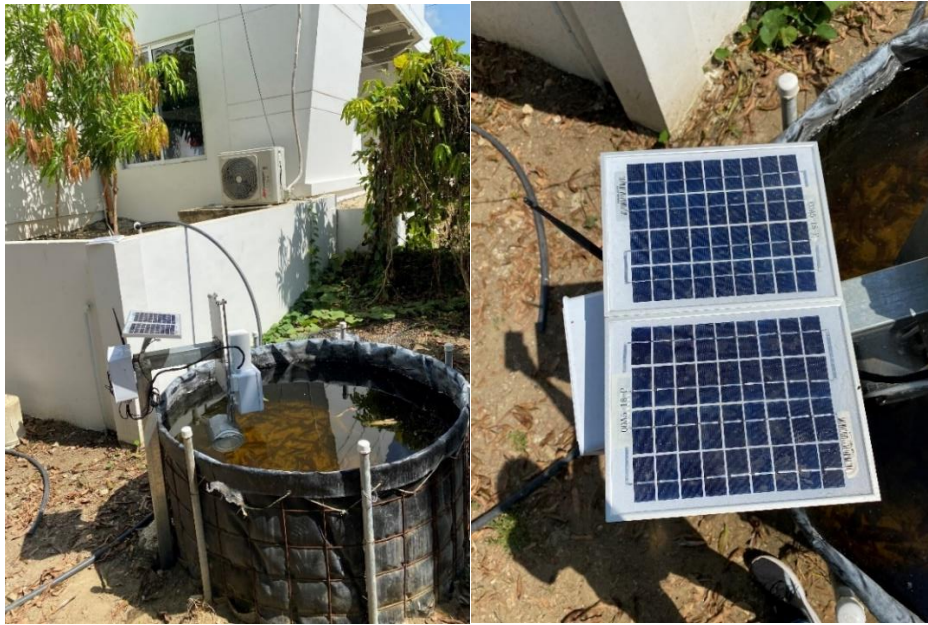
Figura 41. Sistema de alimentación con módulos fotovoltaicos.
