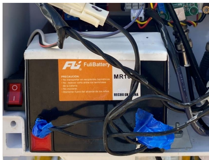
Figura 24. Batería de 12VDC.
