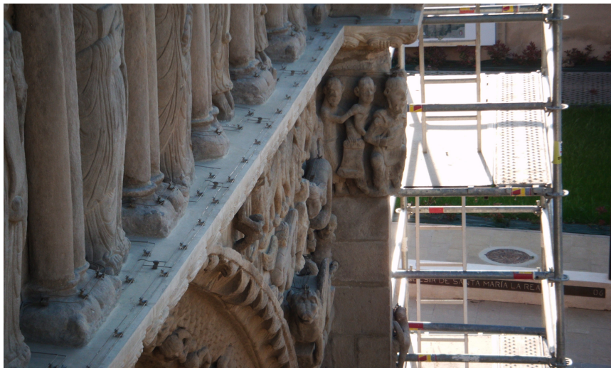
Detalle de sistema anti-palomas en la portada de Sta. María de Sangüesa. (Fotografía cedida por Construcciones Aranguren S.A.U.)
