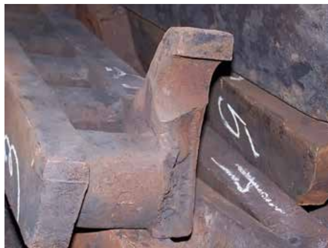
Рис. 8. Разрушение зубчатой рейки Fig. 8. Destruction of the toothed rail
