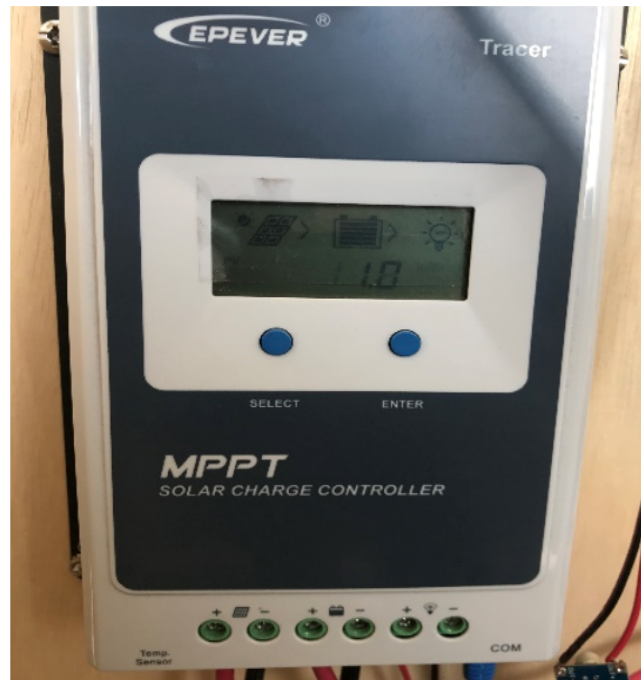
Figura 25. Controlador de carga solar EPEVER 3210 AN. (Elaboración propia)
