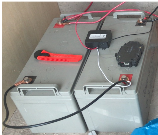
Figura 26. Banco de baterías instalado. (Elaboración propia)
