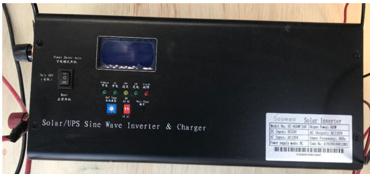
Figura 27. Inversor solar instalado. (Elaboración propia)
