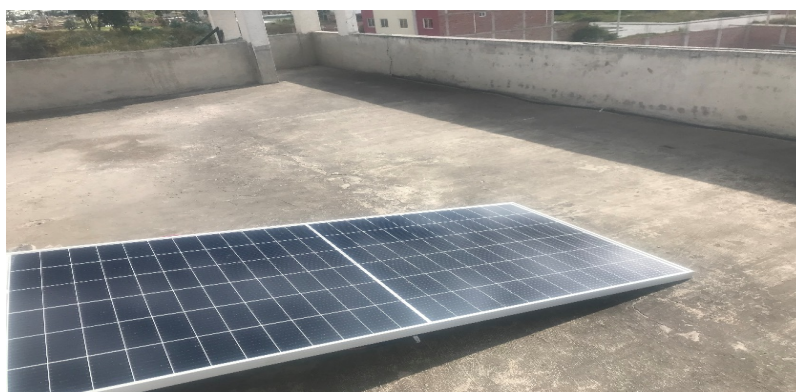
Figura 24. Módulo solar instalado en Riobamba, Ecuador. (Elaboración propia)
