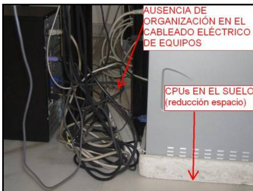
Imagen 19. Cableado eléctrico de equipos
