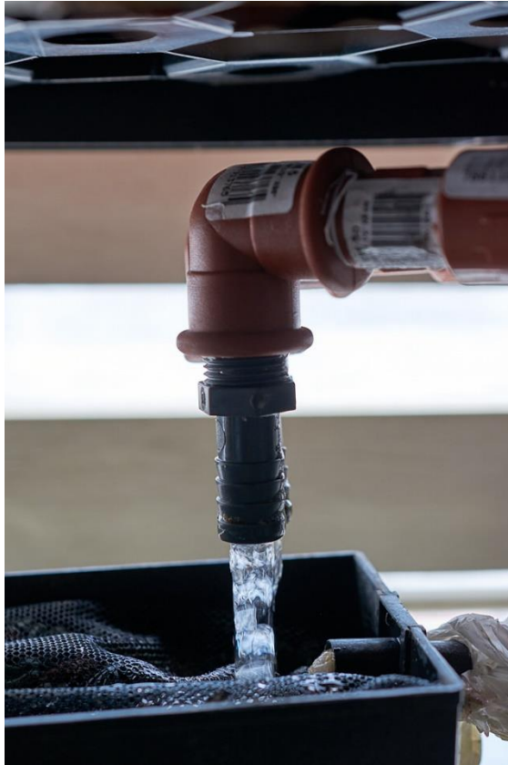
Figura 74. Tubería a la pecera modificación (II)
